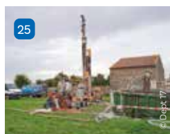
Canton de Pons Géothermie à Bois
